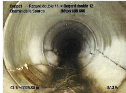
Fissures de la canalisation
