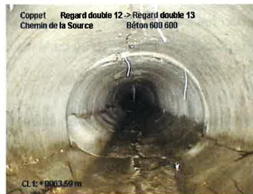
Cassure et ovalisation de la canalisation
