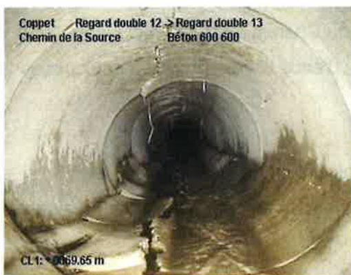
Cassure de la canalisation
