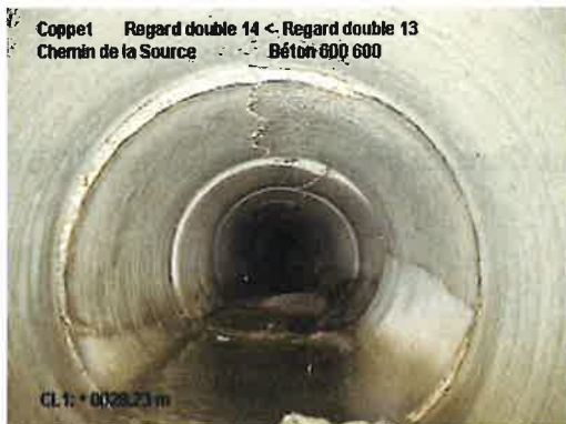
Fissures de la canalisation
