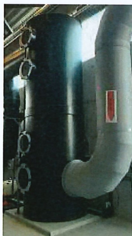
Tour de lavage
