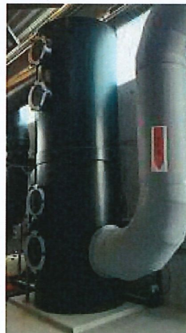
Tour de lavage
