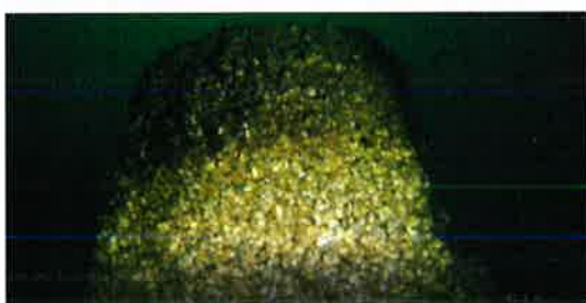
STAP de la Marjolaine : vue sur la crépine lors de l'inspection du 3 juillet 2022
