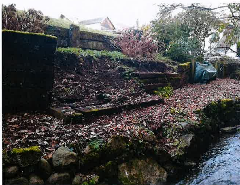
Photo 4 – Planches en bois effondrées (parcelle n° 724)
