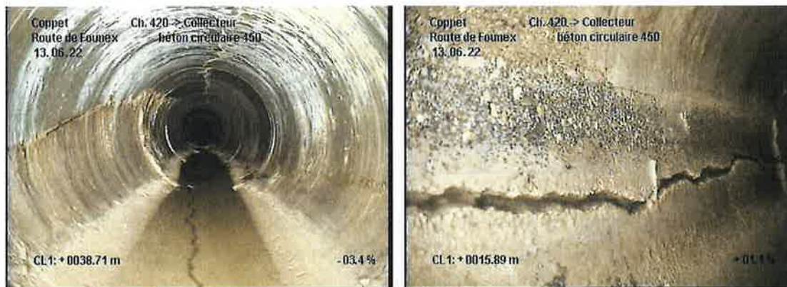
Photos 1 et 2 – Inspection caméra du collecteur EC situé entre le regard EC5 vers l'aval
